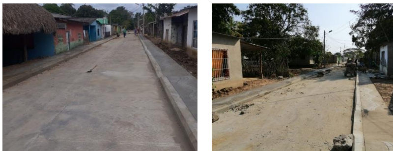
Ilustración 34. Construcción en pavimento rígido y obras de alcantarillado sanitario en vías del corregimiento Trementino Fuente: Secretaría de Infraestructura
