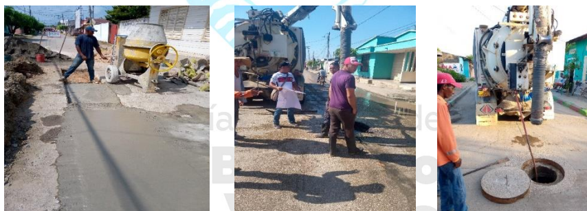
Ilustración 35. Mantenimiento de tramos críticos del sistema de alcantarillado del casco urbano Fuente: Secretaria de Infraestructura
